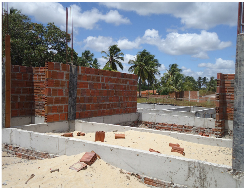
Figura 8 - Obras de unidades de saúde paralisadas e sem previsão de conclusão.
