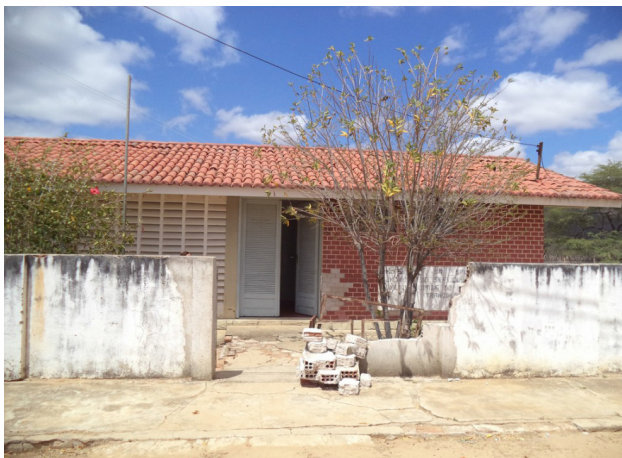
Figura 6 - Fachada de unidade de saúde em desconformidade ao estabelecido pelo MS.
