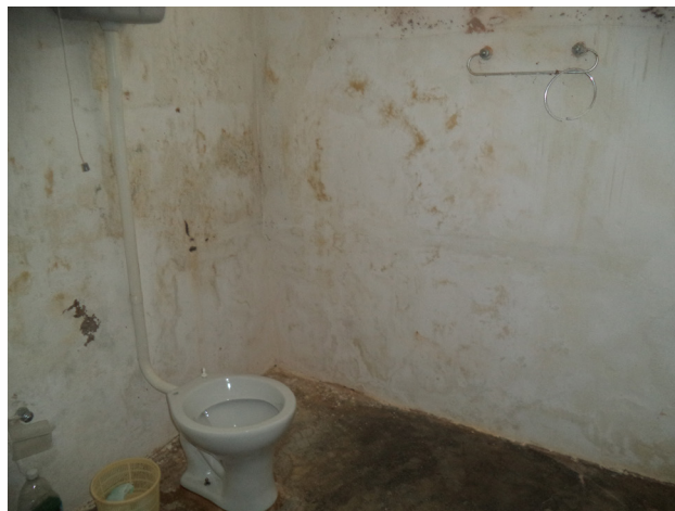
Figura 7 - espaço interno de unidades de saúde em desconformidade ao estabelecido pelo Ministério da Saúde.
